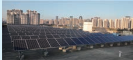
合肥首創奧特萊斯的光伏發電系統
